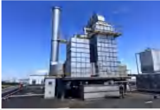
DA002定型废气处理设施1
