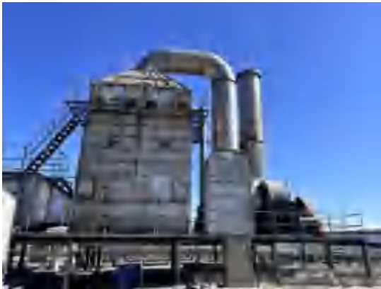
定型废气处理设施5
