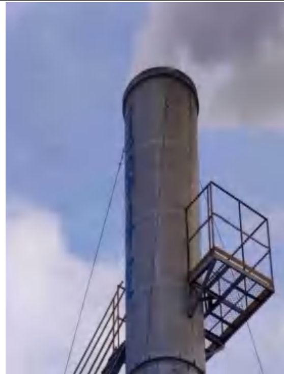
DA025定型废气排放口7
