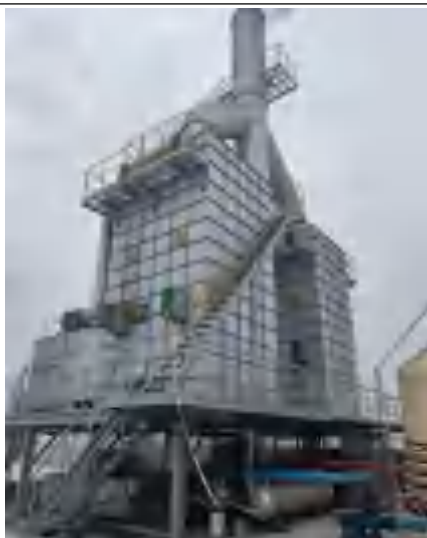
DA025定型废气处理设施7
