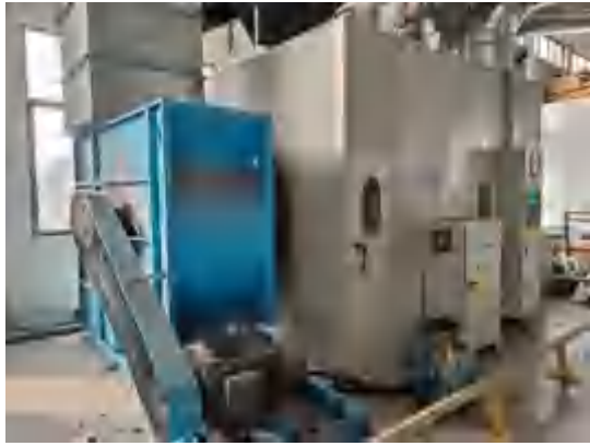
拉毛、剪毛废气处理设施5
