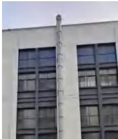
DA028污水站废气排放口2
