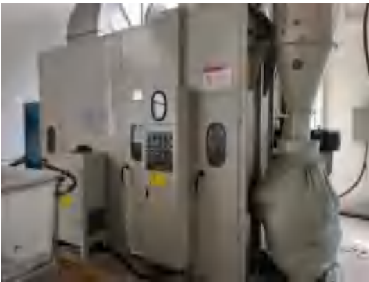
拉毛、剪毛废气处理设施4
