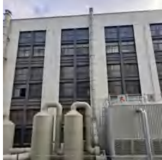
DA028污水站废气处理设施2
