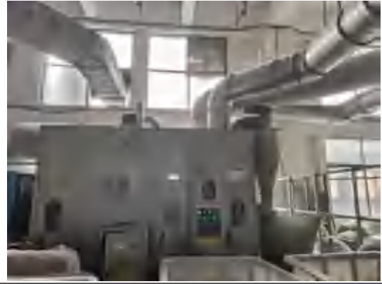
DA030拉毛、剪毛废气处理设施3
