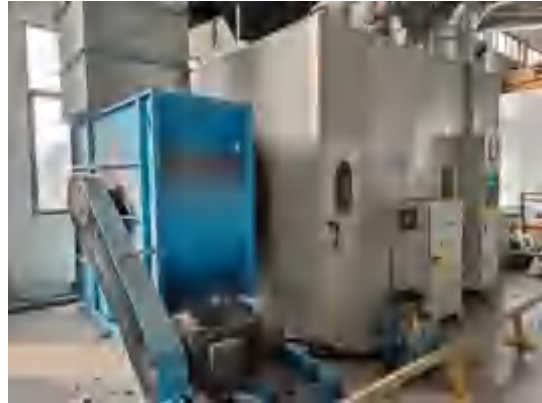
DA032拉毛、剪毛废气处理设施5
