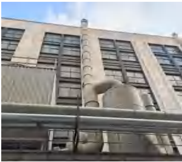
DA009污水站废气处理设施1
