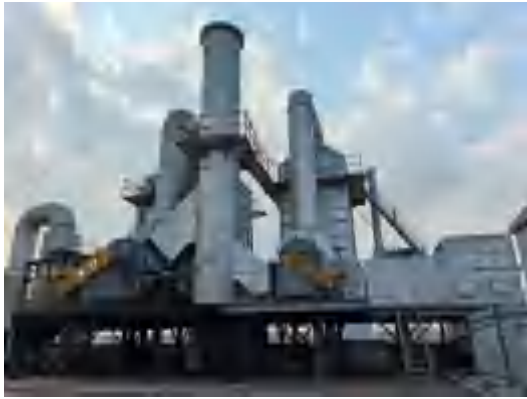
定型废气处理设施3
