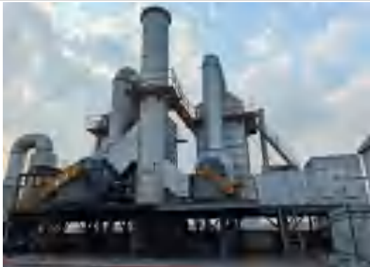
DA012定型废气处理设施3
