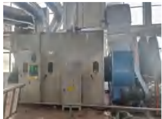
DA003拉毛、剪毛废气处理设施1
