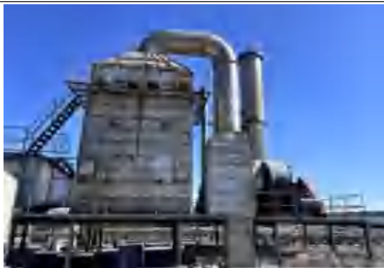
DA018定型废气处理设施5
