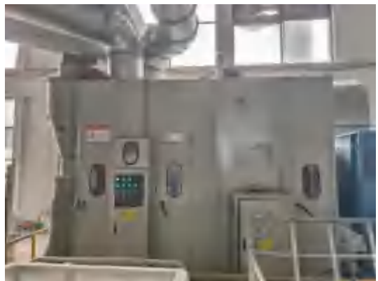
拉毛、剪毛废气处理设施2
