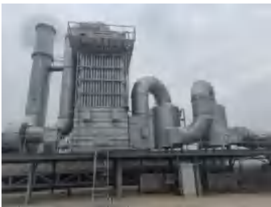
定型废气处理设施6
