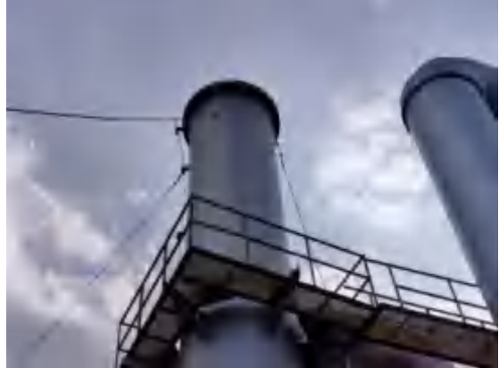
DA012定型废气排放口3
