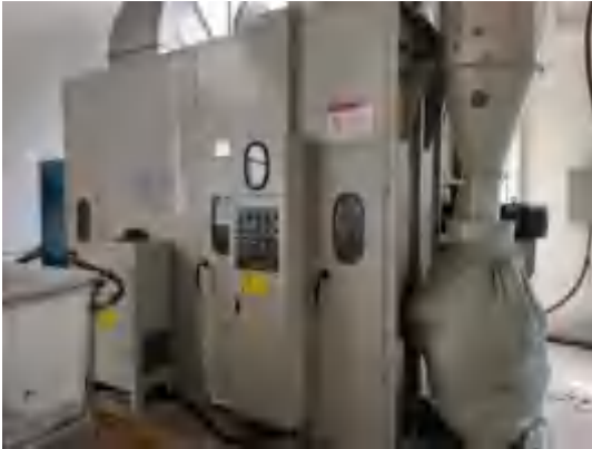
DA031拉毛、剪毛废气处理设施4
