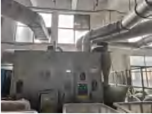
拉毛、剪毛废气处理设施3
