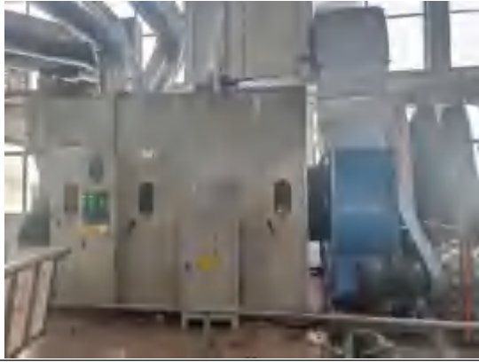
拉毛、剪毛废气处理设施1
