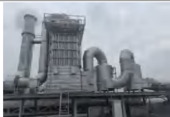
DA024定型废气处理设施6
