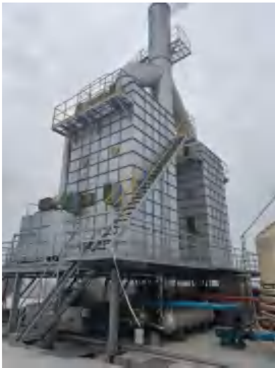
定型废气处理设施7
