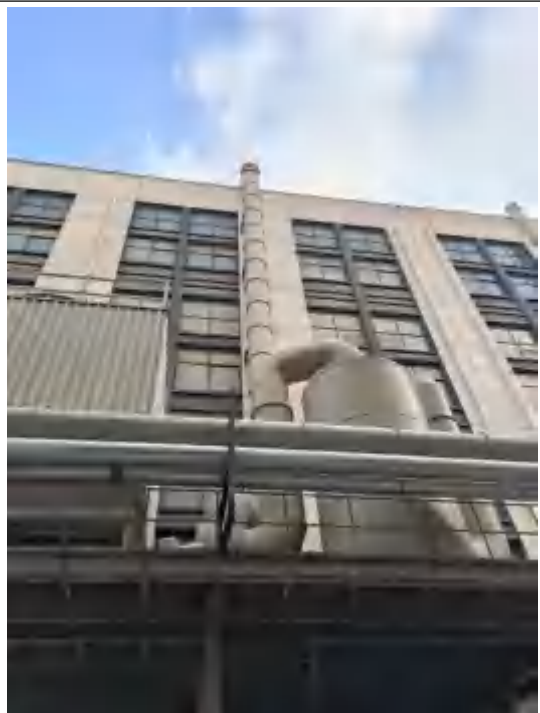
污水站废气处理设施1
