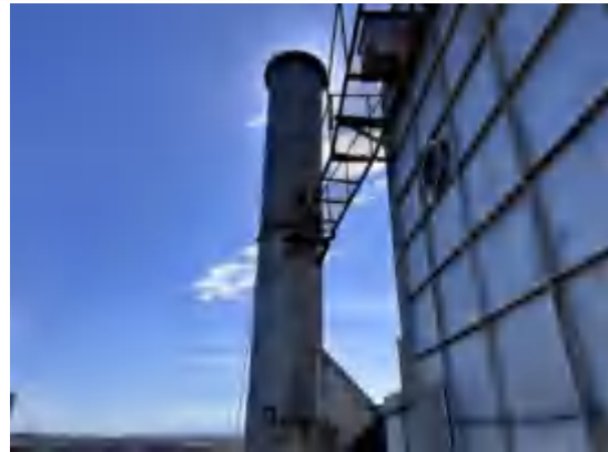
DA018定型废气排放口5
