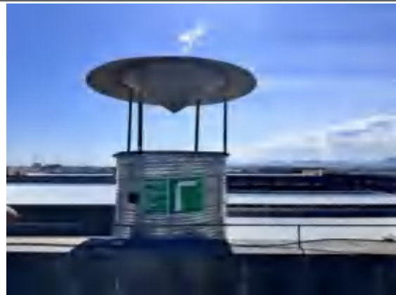
DA029拉毛/剪毛/烫光排放口2
