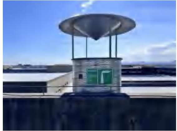
DA030拉毛/剪毛/烫光排放口3
