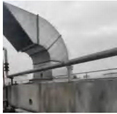
DA003拉毛/剪毛/烫光排放口1
