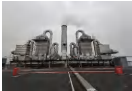
DA013定型废气处理设施4
