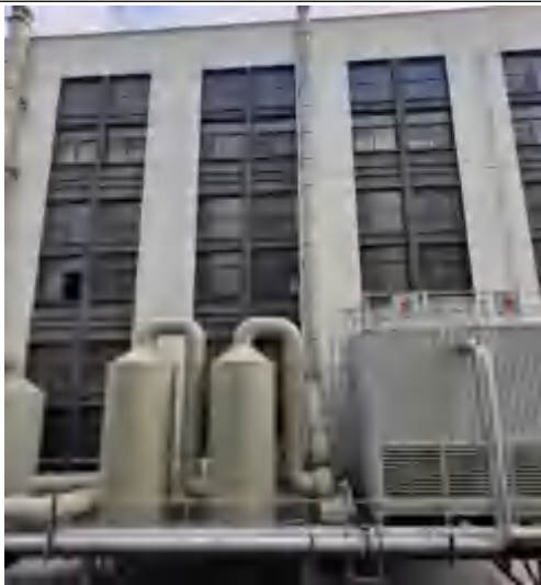
污水站废气处理设施2
