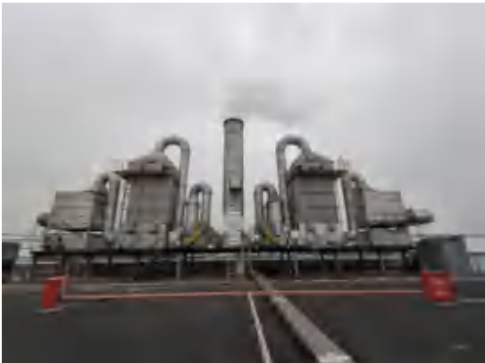
定型废气处理设施4
