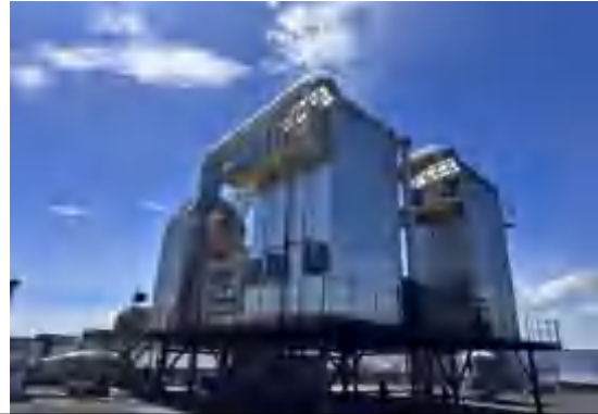
DA010定型废气处理设施2
